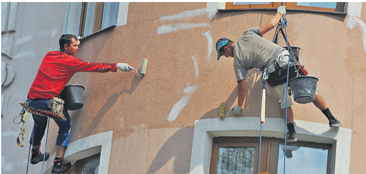
12 августа 2013 года. Промышленные альпинисты выполняют на высоте работы по покраске фасада жилого дома
