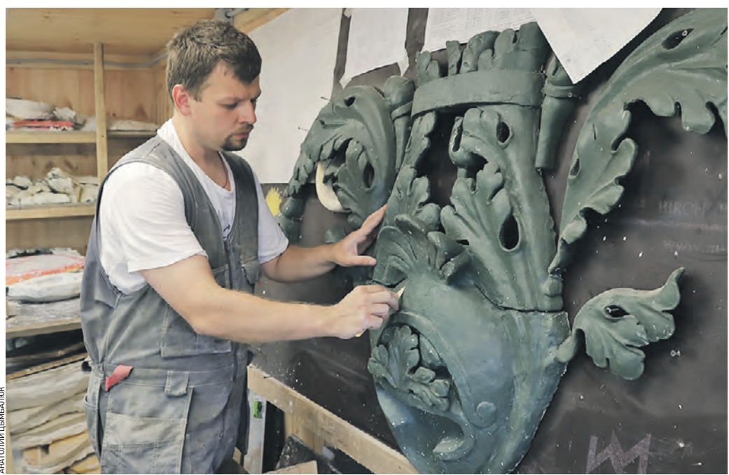
28 июня 2022 года. Реставратор Игорь Щеленков занимается восстановлением лепного декора. Когда он завершит свою работу, декор вернется на свое место на фасаде МГУ им. Баумана
