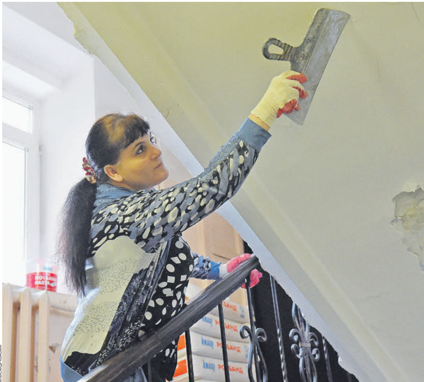
28 июня 2019 года. Штукатур ГБУ «Жилищник района Замоскворечье» Татьяна Иванова снимает старую штукатурку во втором подъезде дома № 10 по Большому Овчинниковскому переулку
