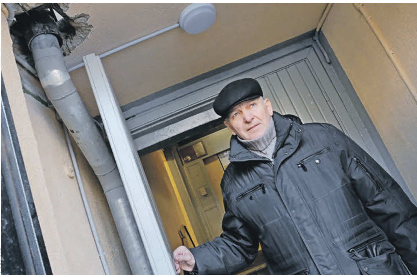
30 марта 10:19 Житель дома № 19 Юрий Федотов у двери, которая открывается с нарушением всех норм безопасности. Причиной тому водосточная труба, которую рабочие установили в подъездном «предбаннике» в ходе капитального ремонта дома
