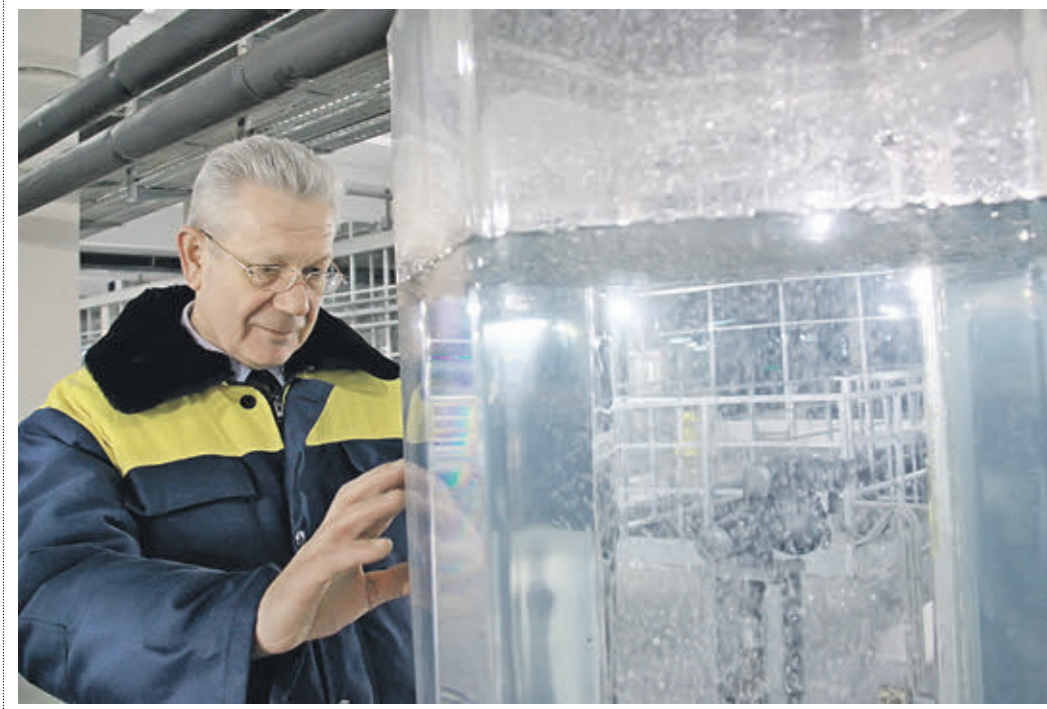
Вчера 11:23 Директор Рублевской станции водоподготовки Сергей Фомичев проверяет работу очистных сооружений, благодаря которым в здания города поступает чистая вода
