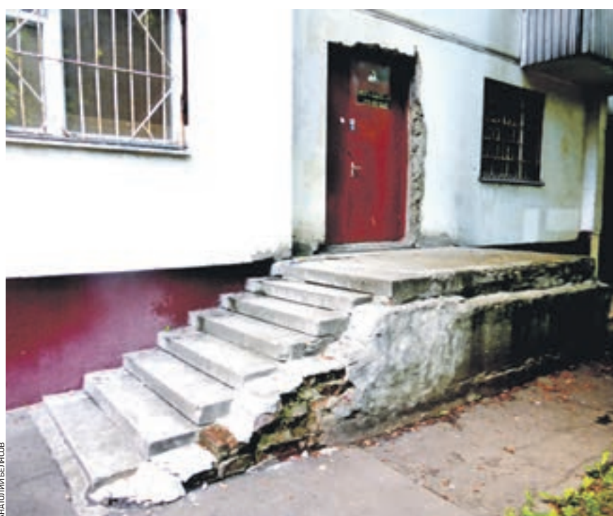
7 августа 2017 года. 15:35 Юрловский проезд, 9. Местные жители сообщают, что лестница, которая ведет в подсобное помещение, находится в неудовлетворительном состоянии, штукатурка обвалилась. Для подтверждения они прислали фото. И очень просили, чтобы лестницу привели в надлежащее состояние. В свою очередь, редакция «ВМ» просит местные власти разобраться с ситуацией и принять меры
