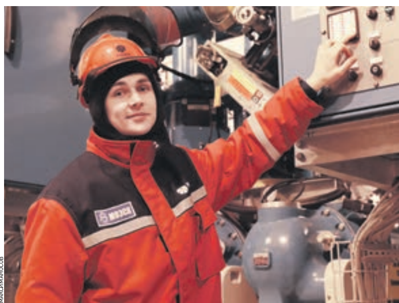
Вчера 10:30 Электромонтер Павел Соколов осматривает состояние приборов на распределительном устройстве в подстанции «Кожневичская»
