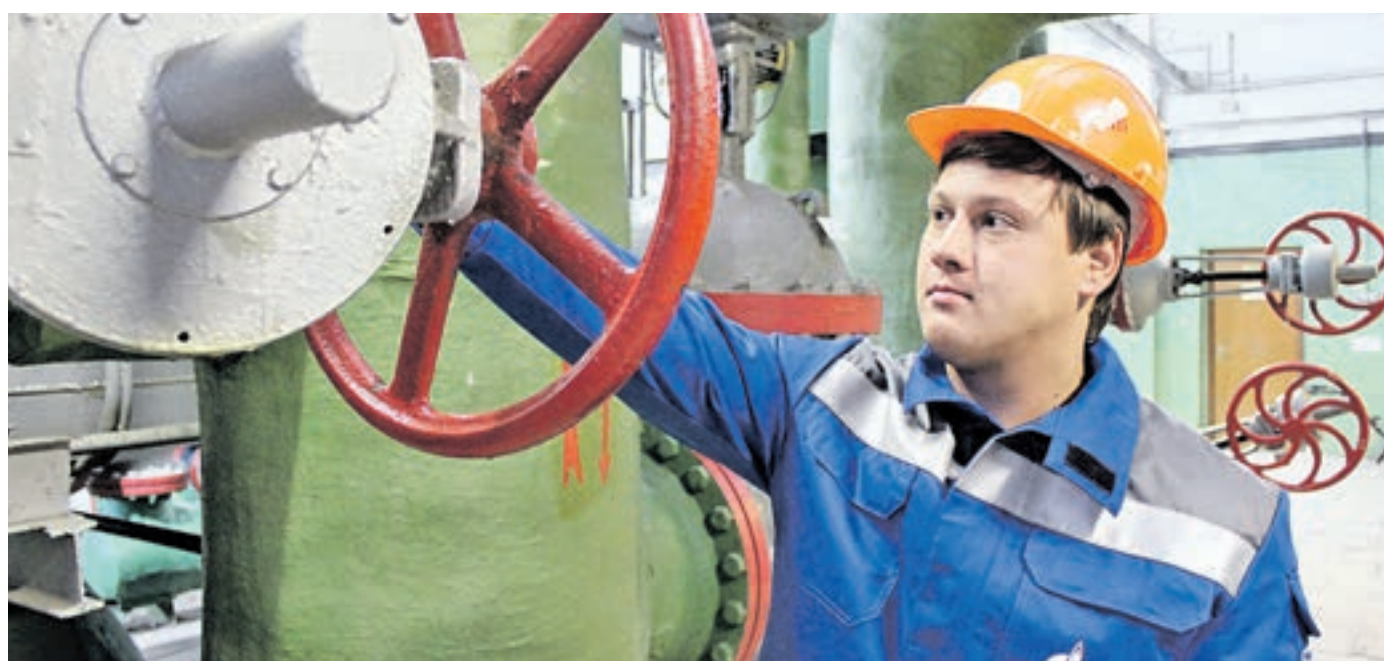
7 июля 2016 года. Старший мастер филиала ПАО «МОЭК» проводит проверку оборудования. Главная задача «МОЭК» — бесперебойное и надежное обеспечение Москвы отоплением и горячим водоснабжением
