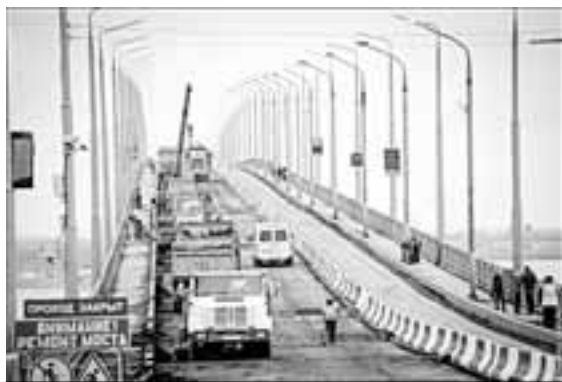
Несколько лет назад ремонт моста стал испытанием для тех, кто ездит на работу или учебу из одного города в другой.
