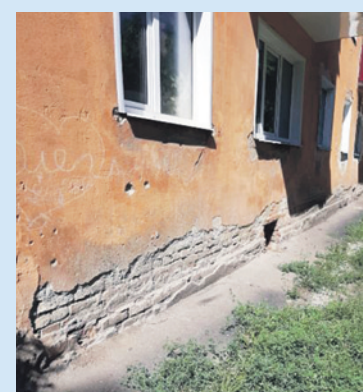
Жильцы уверены, что до такого состояния дом довела обслуживающая организация.
