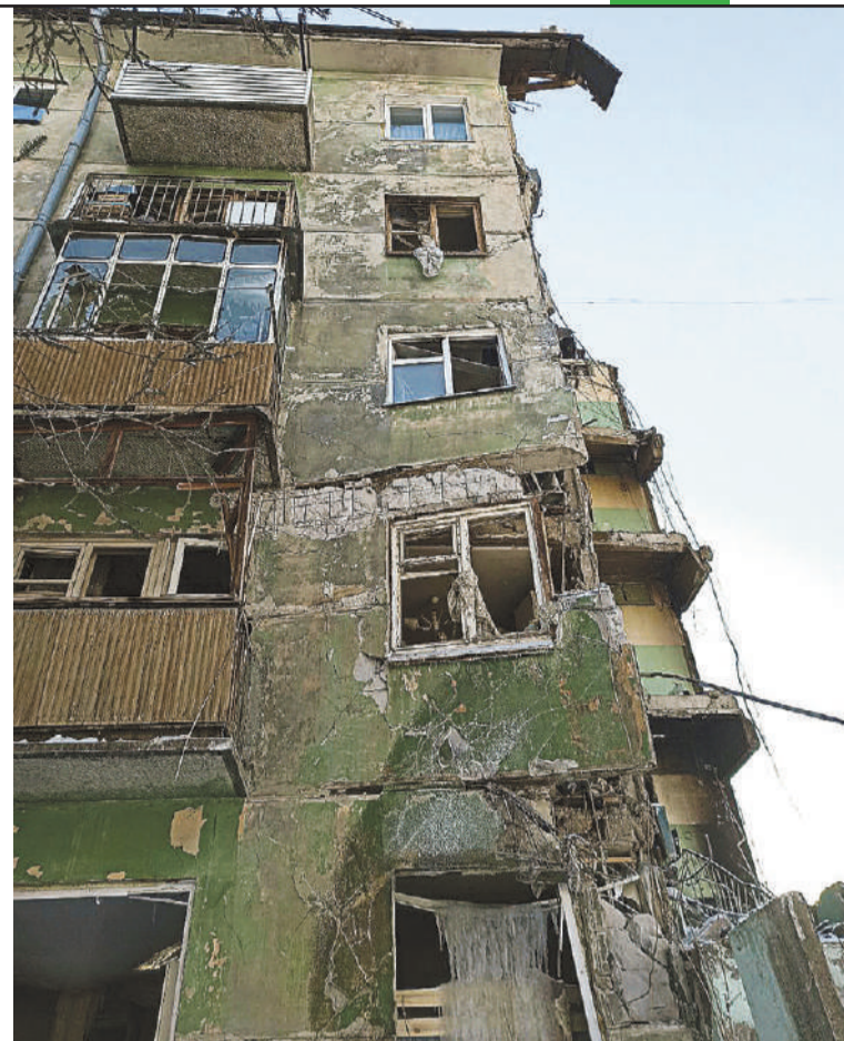
После ЧП дом быстро признали аварийным и снесли.
