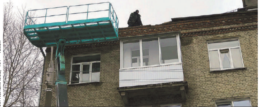
Пламя выгло кровлю сразу над двумя подъездами - первым и вторым.
