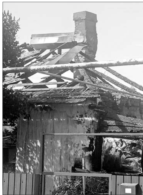
Огонь уничтожил кровлю дома барачного типа.
