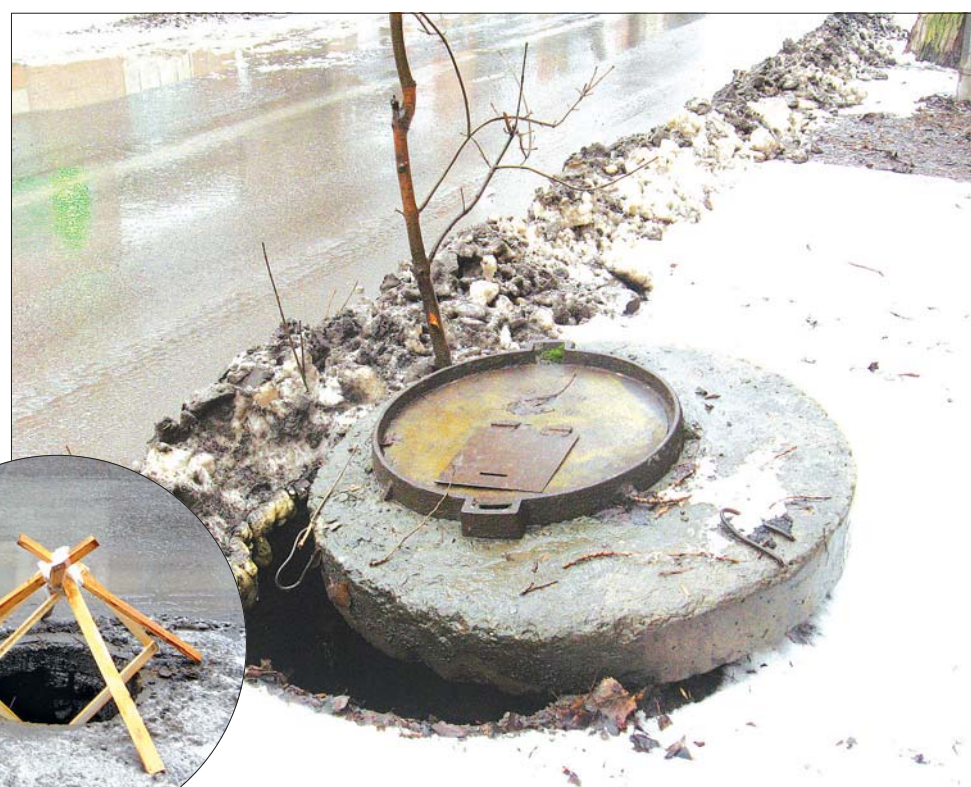
Тяжёлую железобетонную крышку от люка снёс трактор, чистивший снег на улице Халтурина.
